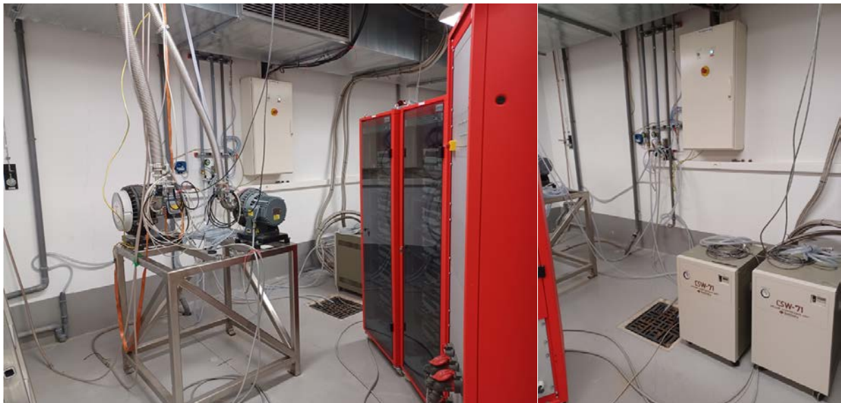
Installation au sous-sol
